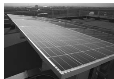
南館に設置された太陽光発電システム
