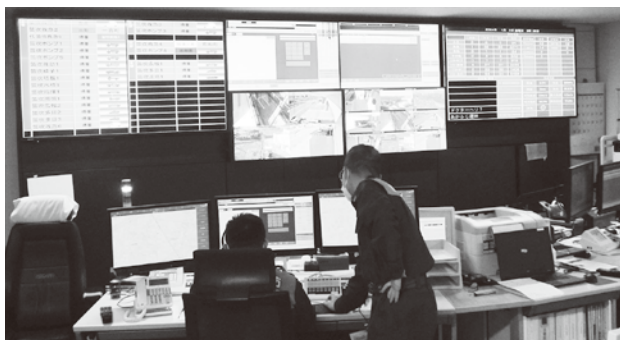
消防指令センター
