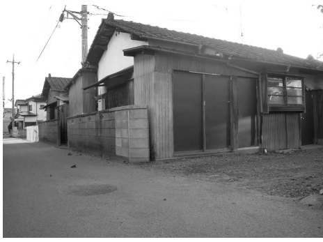
老朽化が懸念される市営住宅
