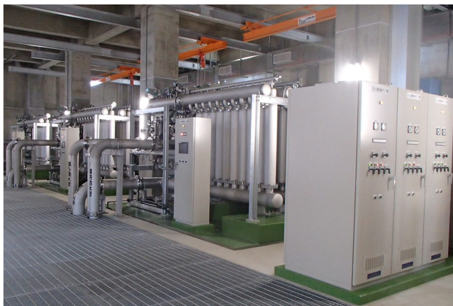
御坂浄水場 膜ろ過棟内部
