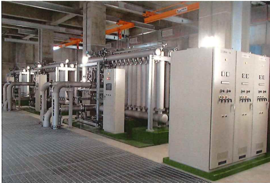
御坂浄水場 膜ろ過棟内部
