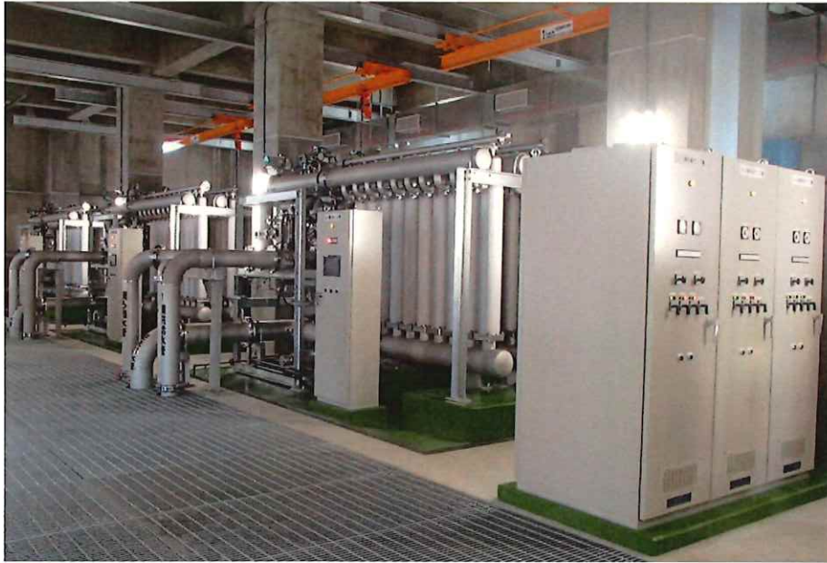
御坂浄水場 膜ろ過棟内部
