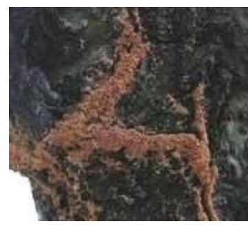
蟻道 (蟻が移動するトンネル)
