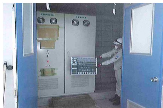
発電機制御盤
