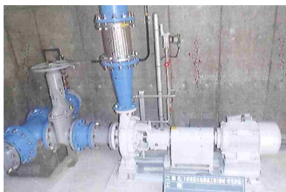
小水力発電システム
