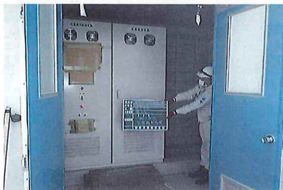
発電機制御盤
