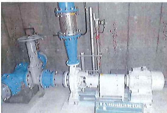
小水力発電システム
