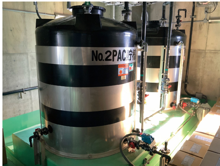
写真 5-1-2 PAC の貯蔵状況（御坂浄水場）
