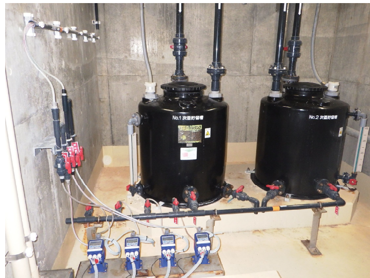
写真 5-1-3 塩素剤の備蓄状況（境川浄水場）
