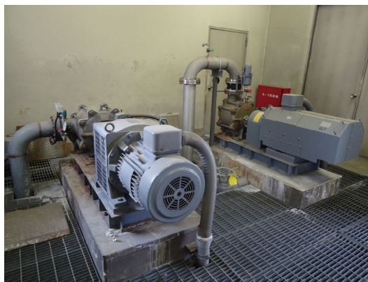
写真 5-1-5 唐柏配水場配水ポンプ
