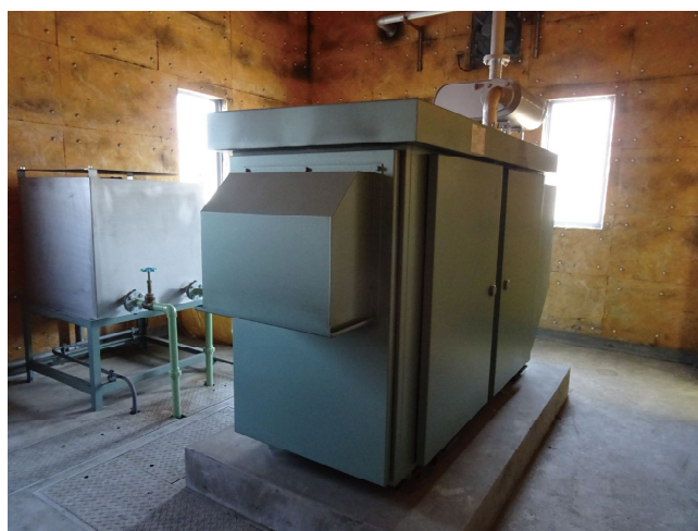
写真 5-1-4 自家発電設備（中川第1配水場）
