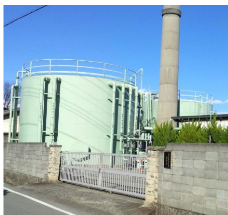
写真 温泉配湯施設(加熱所)
