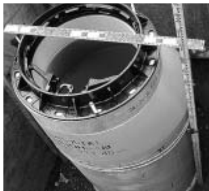
整備が進む下水道事業
