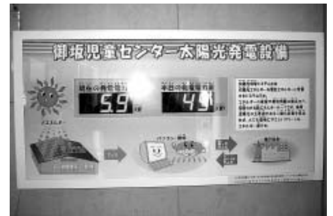
発電状況表示板
