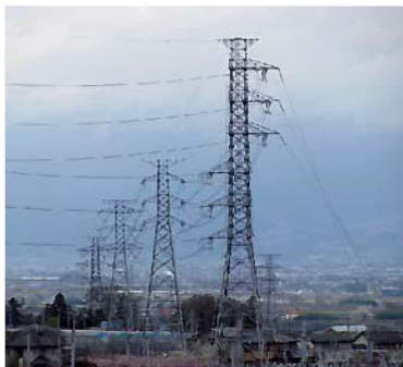
・送電線と鉄塔
