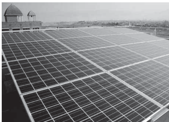
▲ 太陽光発電システム
