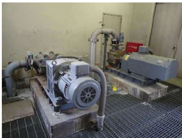
写真 5-1-5 唐柏配水場配水ポンプ
