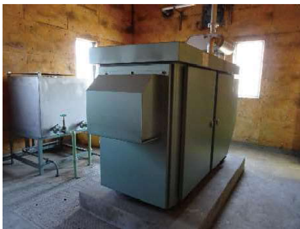
写真 5-1-4 自家発電設備（中川第1配水場）
