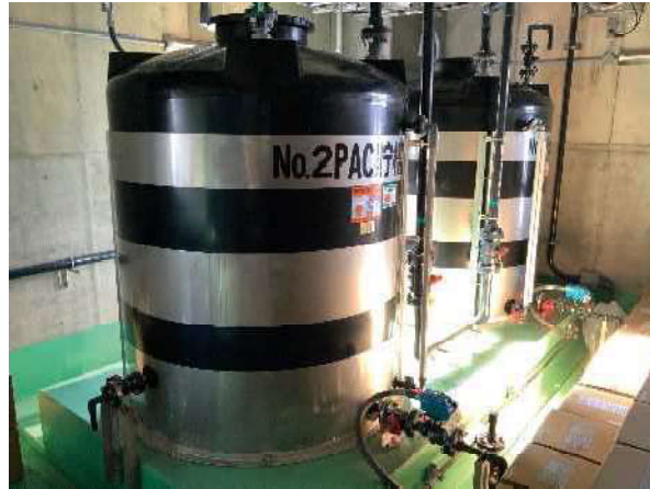
写真 5-1-2 PAC の貯蔵状況（御坂浄水場）
