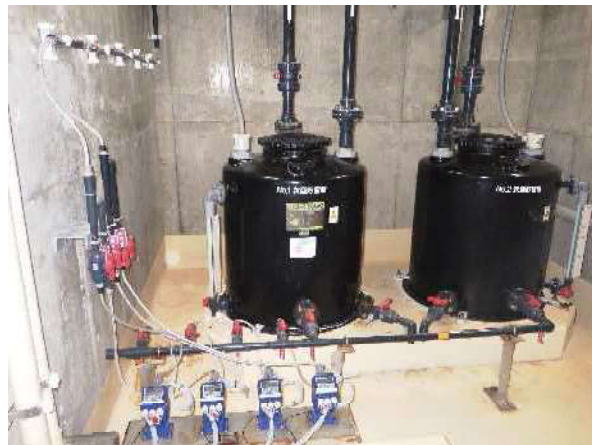
写真 5-1-3 塩素剤の備蓄状況（境川浄水場）
