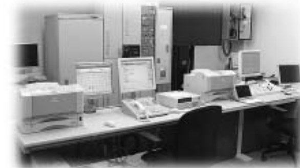
笛吹市役所南館4階 防災無線指令室
