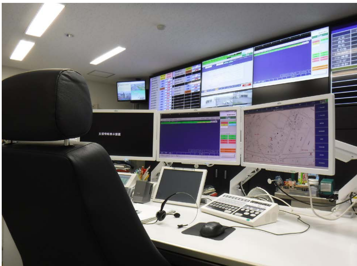
笛吹市消防本部 高機能消防指令センター
